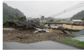
根室線下新得川橋梁他 橋梁流出 災害復旧調査詳細設計
